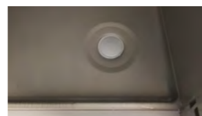
Bonde d'évacuation des eaux de nettoyage
